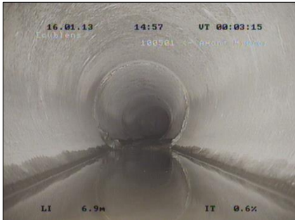
Exemple de collecteur en bon état.
