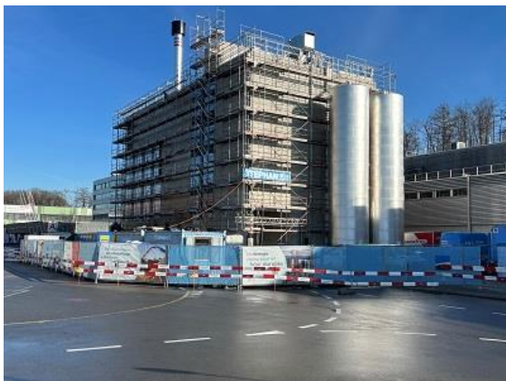
Chemin du Dévent – Nouvelle centrale de chauffage à distance avec chaufferie à bois
