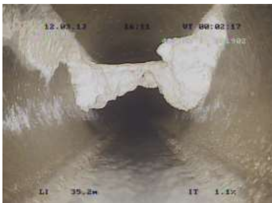
Après curage d'un dépôt de sable, il subsiste un « pont » de calcaire qu'il faudra fraiser.
