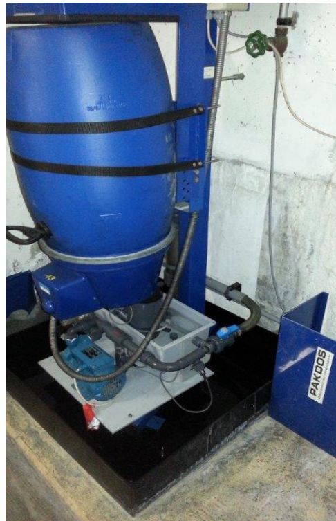
Distributeur de produits chimiques dans la piscine
