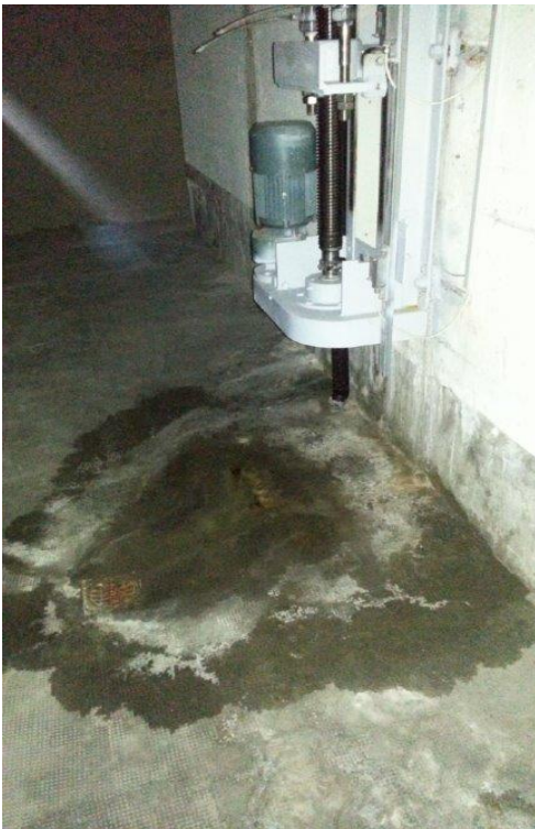
Le système de variation de niveau d'eau dans la piscine a subi des réparations de fortune et comporte des fuites
