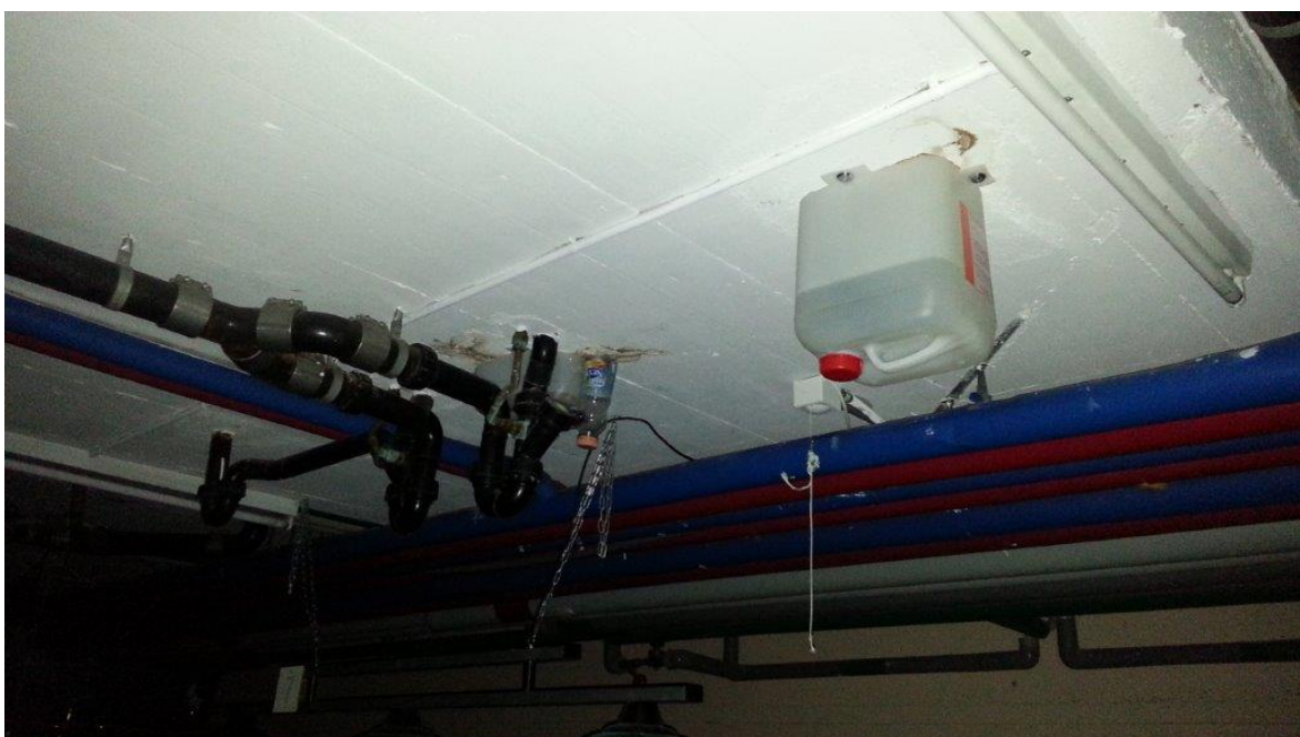
Des récipients en plastique sont utilisés dans certains locaux du sous-sol du bâtiment pour recueillir les fuites d'eau; ils doivent être vidés régulièrement, sous peine d'inondation !
