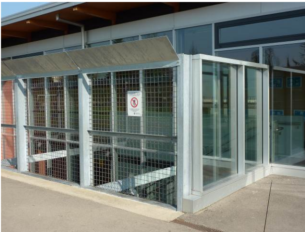
Le grillage supplémentaire à 45 degrés installé sur la fosse dangereuse n'est pas convaincant
