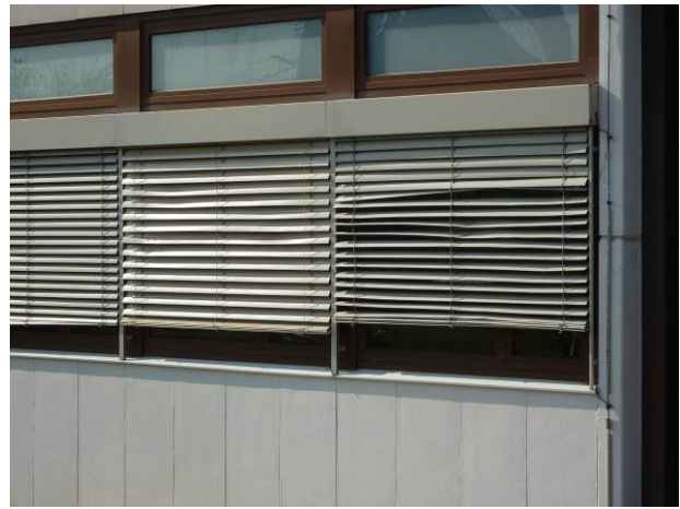
Certains stores des bâtiments scolaires sont en mauvais état
