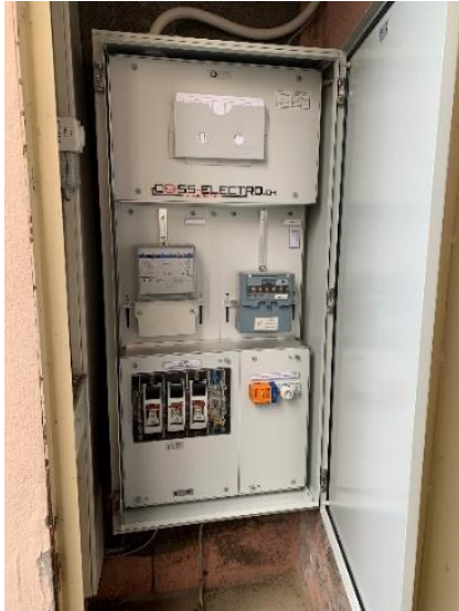
Nouveau tableau d'introduction électrique
