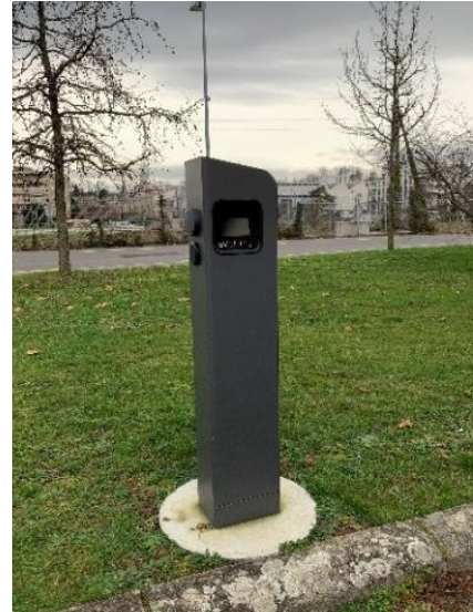
Nouvelle borne de recharge
