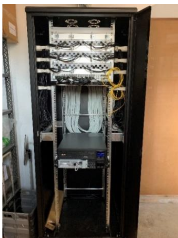
Nouvelle armoire informatique
