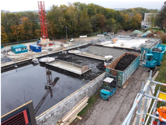
EPFL : centrale de chauffe
