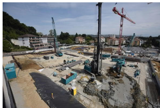
Exécution des pieux de fondation du bâtiment et du rideau de palplanches – août 2017
