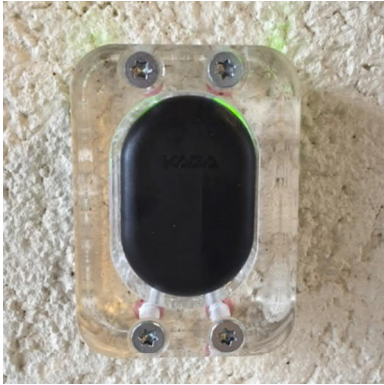
Contrôle d'accès Kaba
