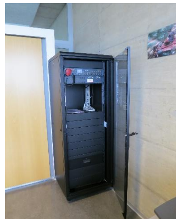
Coquerellaz – Nouveau rack de sonorisation et d'évacuation incendie
