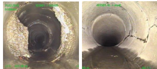
Collecteur avant gainage (calcaire et fissures)
