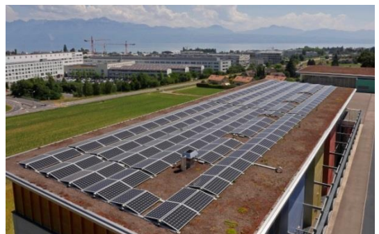
Panneaux photovoltaïques – Coquerellaz
