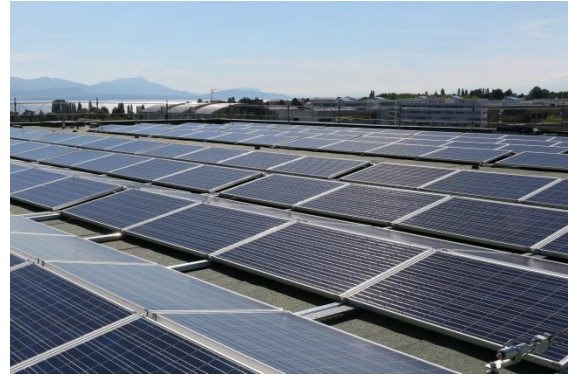
Panneaux solaires sur la toiture du bâtiment mécanique de l'EPFL
