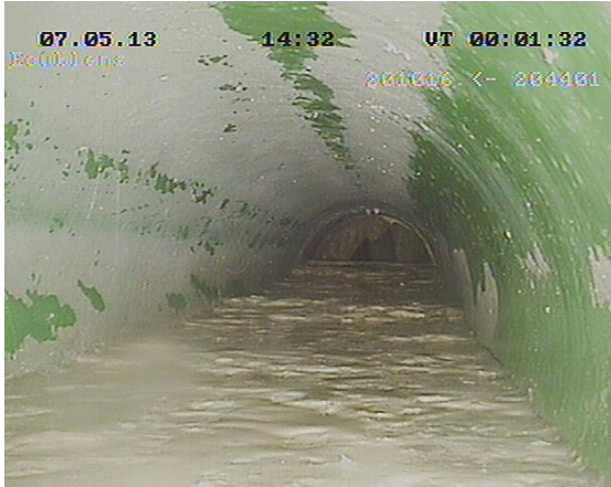
Dépôt important de calcaire
