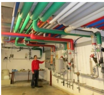
Exemple d'une installation technique communale
