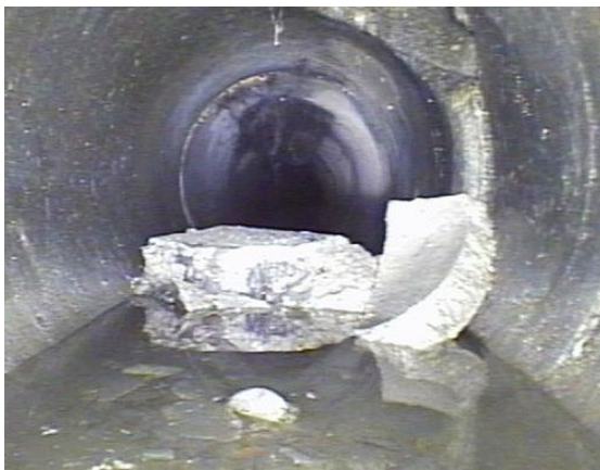
Éléments de béton obstruant le collecteur
